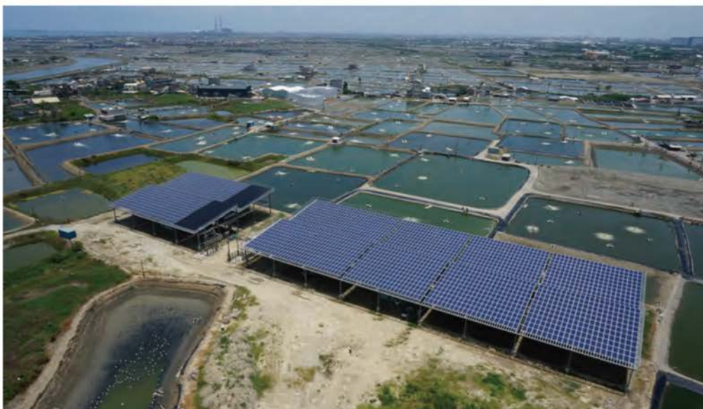
永安農漁業設施 設置容量：720Kwp 發電量：919,800度/年
