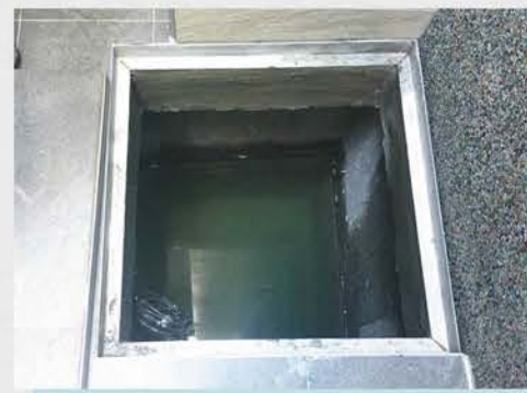
雨水貯集設施
