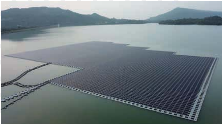
(一) 浮力式太陽能綠電發電設備 (水面型)
