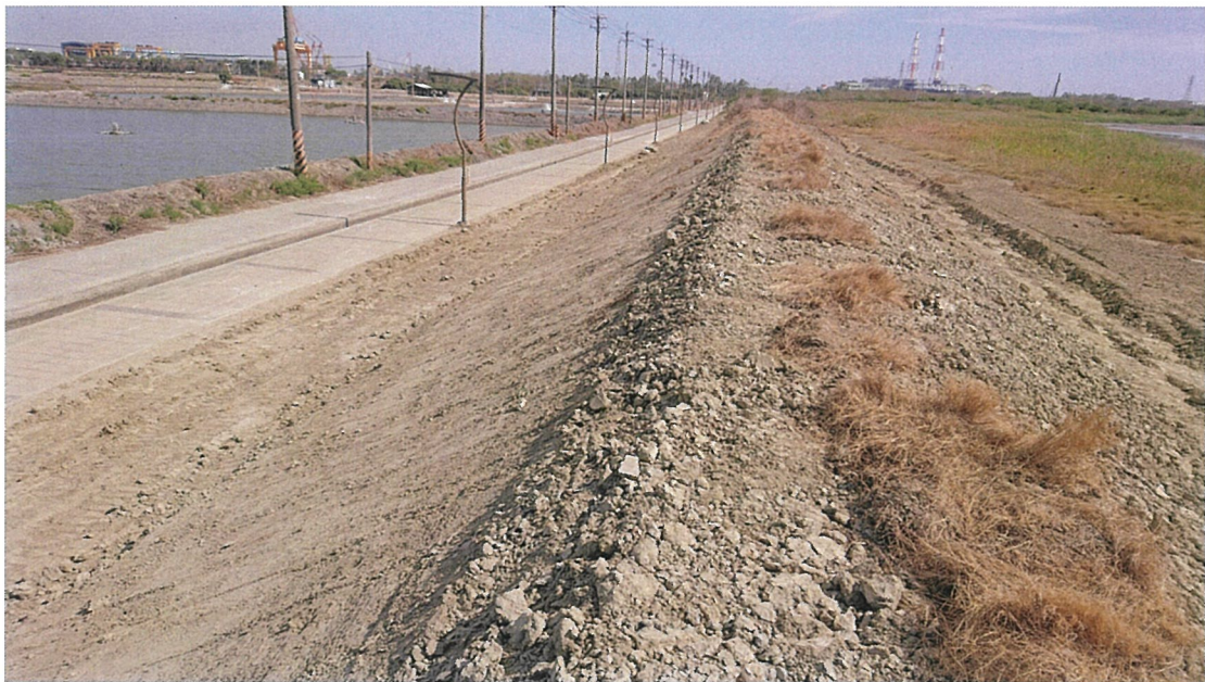
圖十六、濕地東側土堤及自行車步道、景觀高燈等設施（為 110 年土堤塌陷維護後照片）
