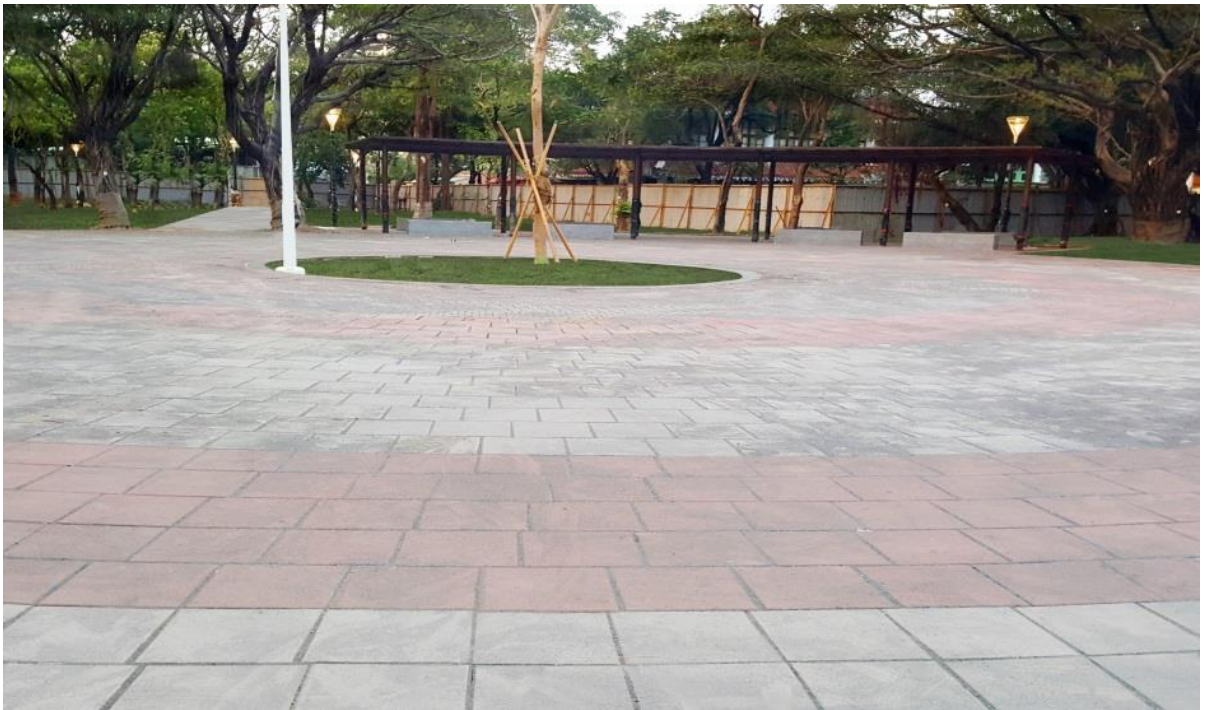
圖 20 圓形廣場（施工前）vs 圓形廣場（施工後）—改造前的圓形廣場棚架下多為賭客占據區，且騎機車進入後，任意放置
