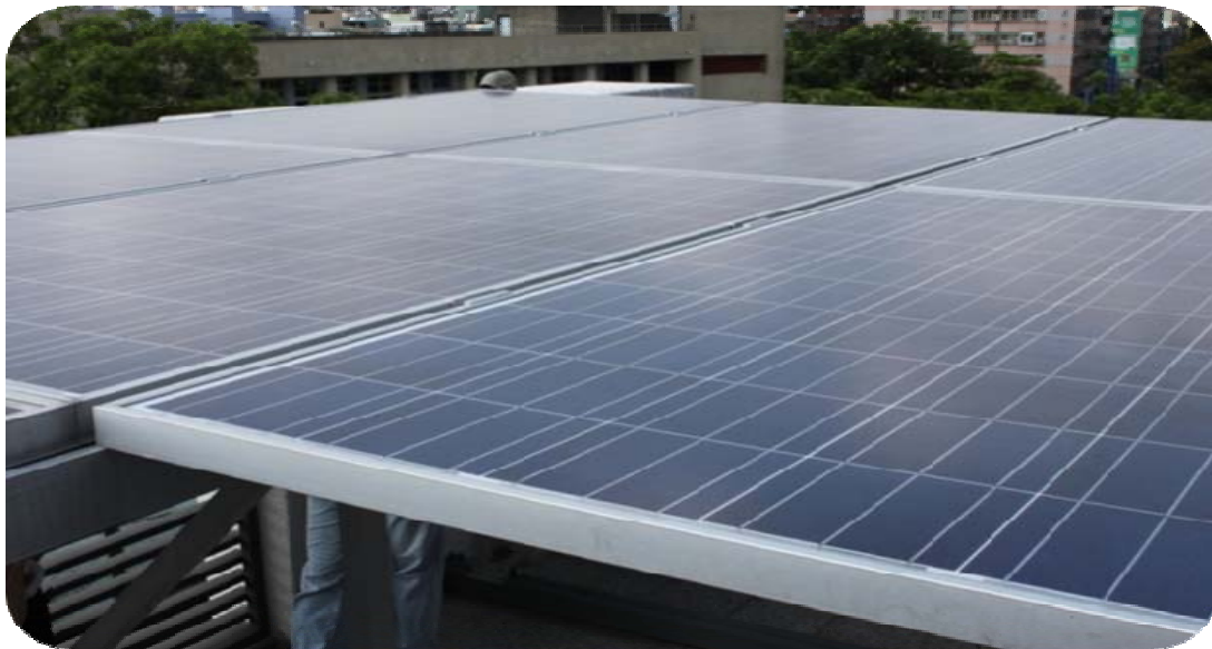
圖 2-17 民宅裝設太陽光電(前鎮)
