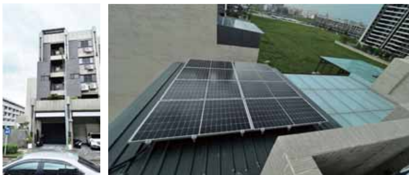
高雄市鳳山區 屋後綠能設施 19.97 m 2 、太陽光電 2.04 kW
