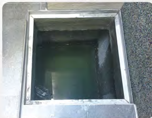
D、雨水貯集設施
