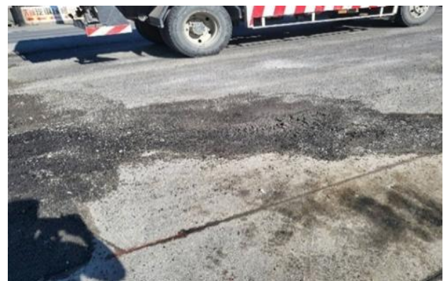
圖 1 CLSM 未達承載強度之破壞狀
