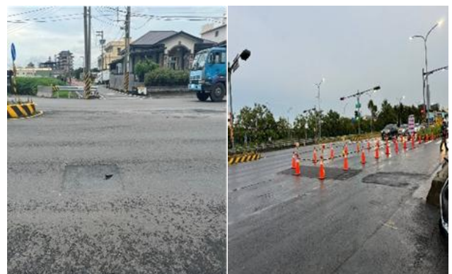
圖 2 零星管挖鋪面受水侵害破壞狀
