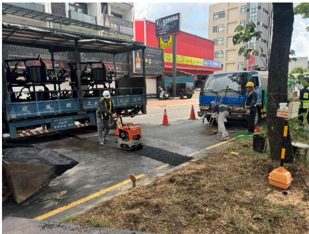
圖 6 現場架設遠端即時監控系統
