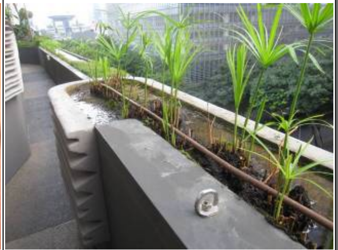
植栽自動供水系統
