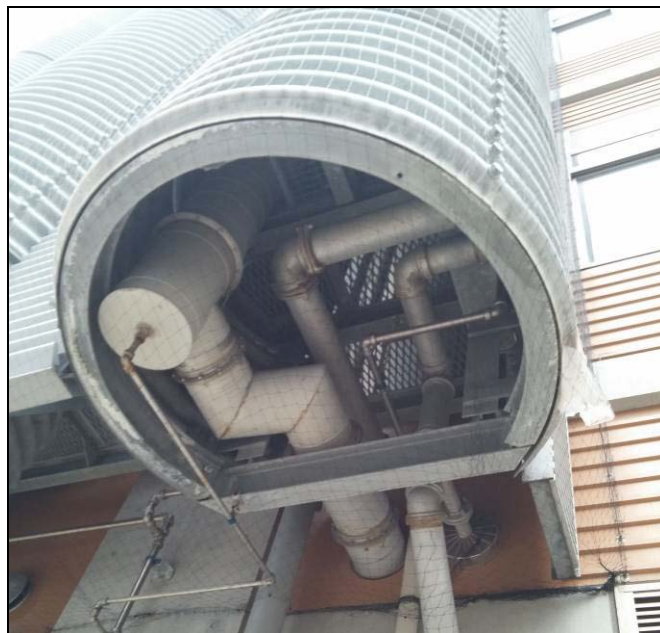
圖 2.3-34 九州大學伊都校區西側教學大樓外露管線處理
