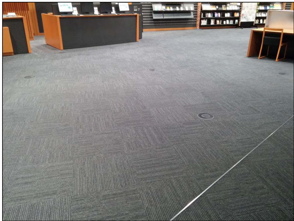
圖 2.3-39 福岡大學中央圖書館空調地板出風口
