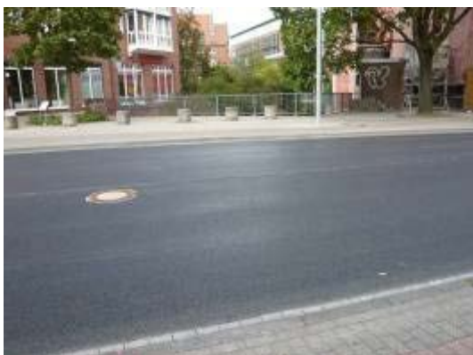
道路中央留有不平整的施工接縫
