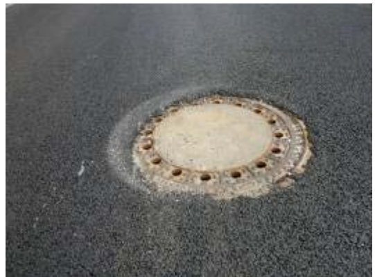
孔蓋與路面未齊平
