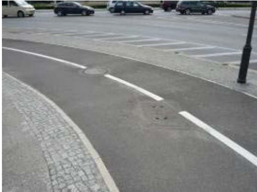
路面標線遇到孔蓋不劃設
