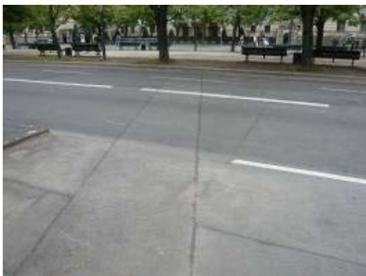
路面修補痕跡
