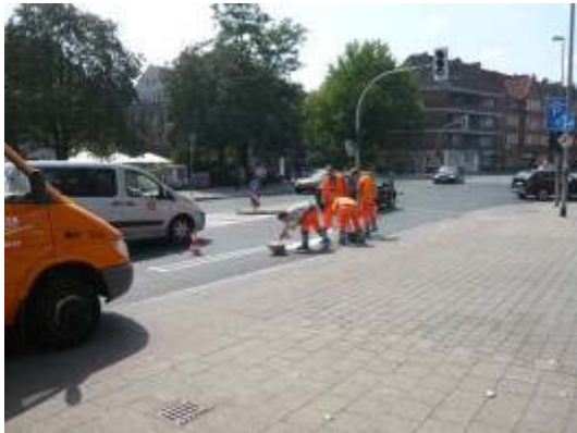
標線施工未作交維
