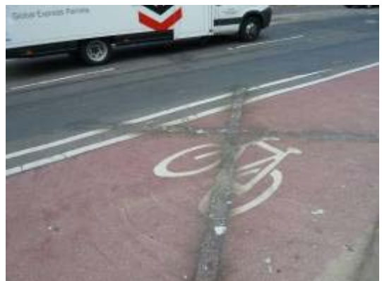
標線復原後有明顯的黑色痕跡
