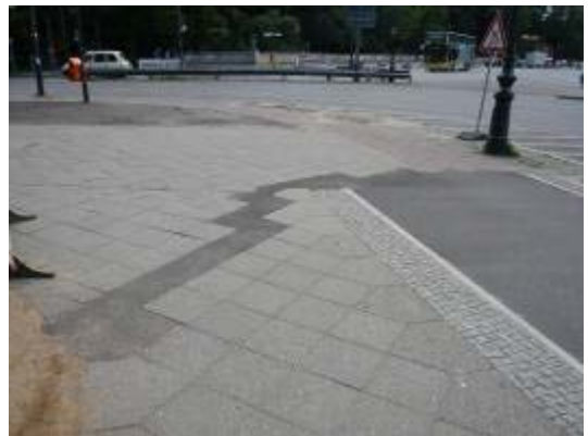
部分地磚損壞以 AC 修補
