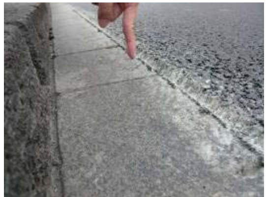
柏油路面比路緣石高約 2 公分
