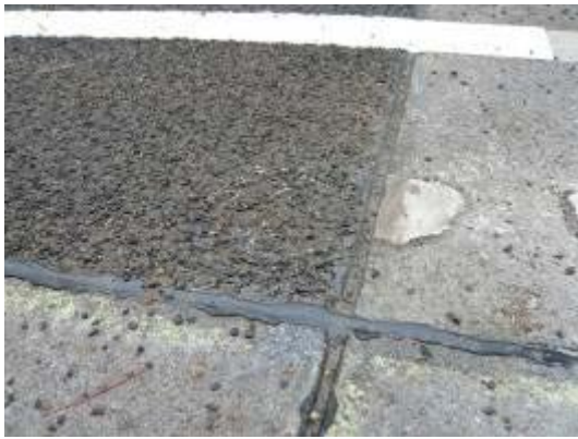
路面修補痕跡
