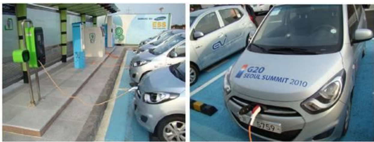
圖 濟洲智慧電網電動車充電設施
