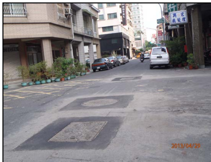
道路人手孔甚多，致使路面不平，常導致用路人產生行車風險
